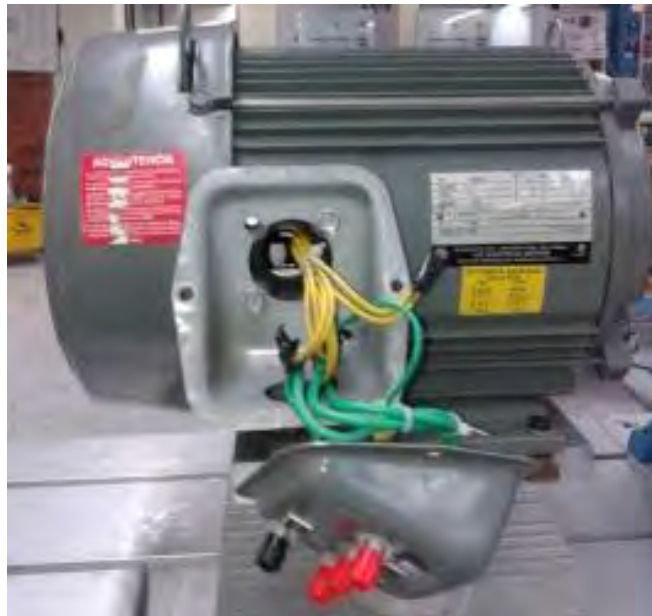
Figura 53. Apertura de la bornera del motor de inducción para introducir sonda de medición de temperatura
