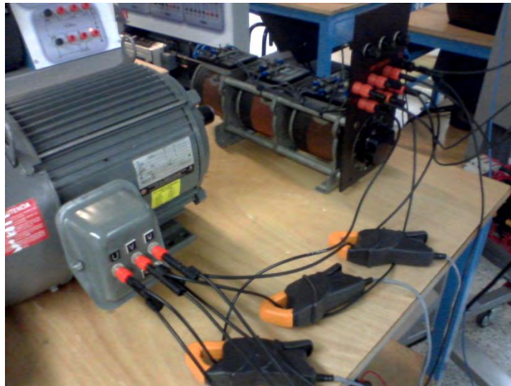
Figura 24. Motor alimentado por autotransformador para ensayos de vacío, rotor bloqueado y deslizamiento a tensión reducida
