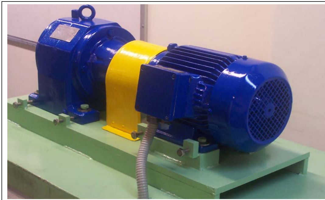
Foto 6 Vista general del banco de alineación lado motriz
