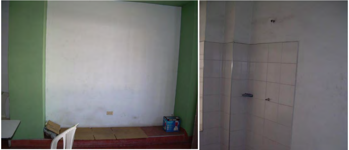
Figura 14. Situación actual de baño y zonas sub utilizada
