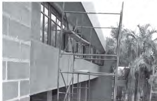
FOTO: Aspecto del edificio de Aulas 2 al término de las intervenciones arquitectónicas.
