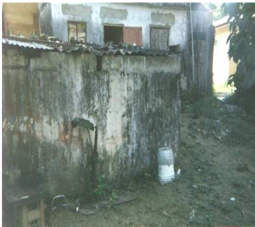
Figura 19. Cisterna de cemento.
