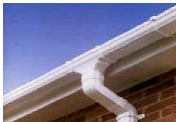
Figura 4. Canaletas de recolección
