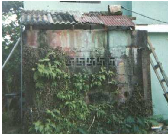
Figura 14. Almacenamiento de agua del acueducto
