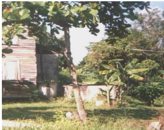
Figura 22. Cisterna en mal estado
