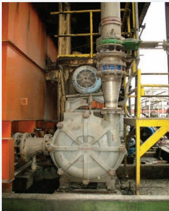
Figura 23. Foto del conjunto Bomba – Motor, sistema Báscula de Jugo
