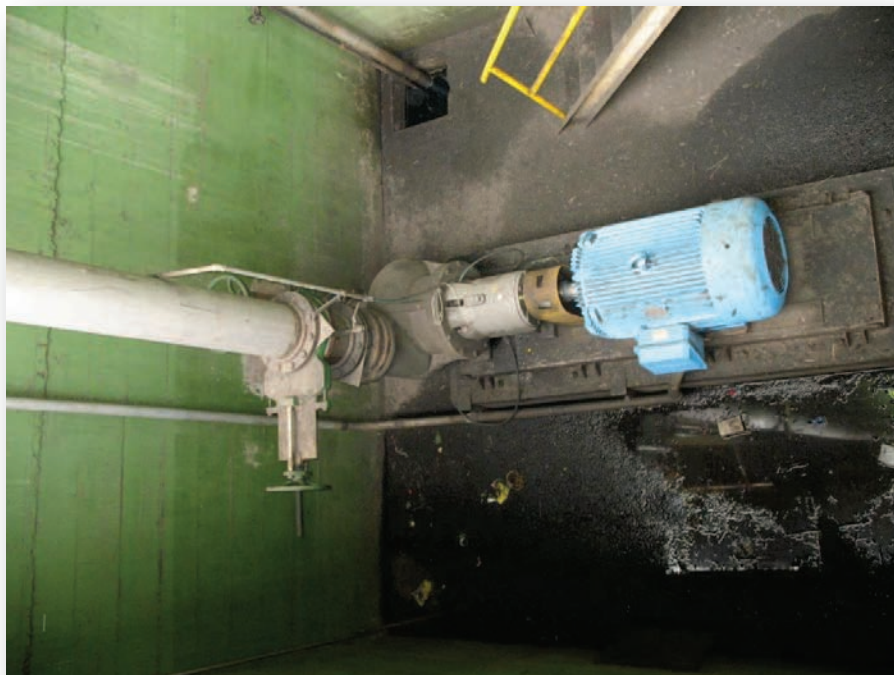
Figura 20. Foto del conjunto Bomba –Motor, sistema Bomba Tromel.
