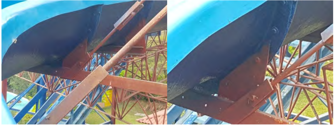
Fig. 48. Desajuste tornillos. (a) Vista general. (b) Vista detallada.
