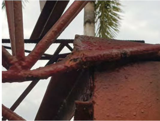
Fig. 29. Deformación plástica de la cercha.
