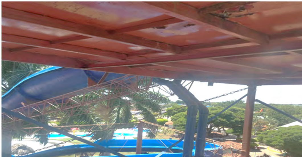
Fig. 7. Daño en la plataforma.
