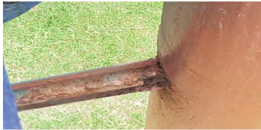
Fig. 46. viga en torre de soporte corroída.
