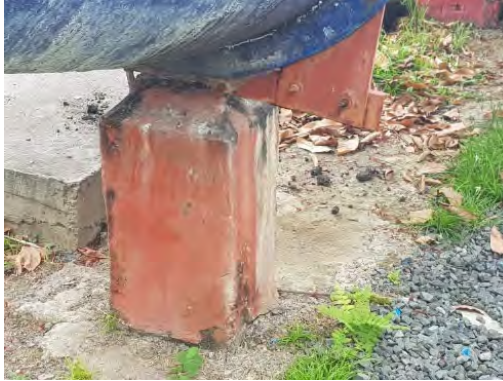
Fig. 43. Dados de concreto en deterioro.
