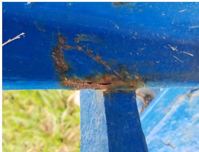
Fig. 30. Daños en los apoyos.
