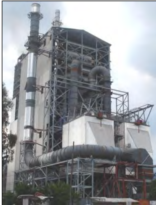
Figura 6.Foto Caldera de Recuperación (UR3)
