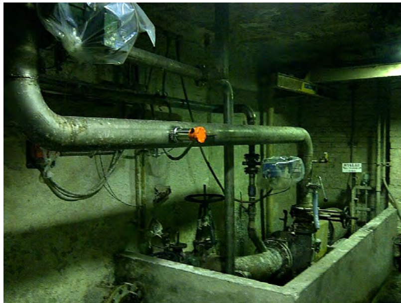
Figura 17. Foto Sistema de bombeo tanque 12 del Molino Uno de Cartón de Colombia.
