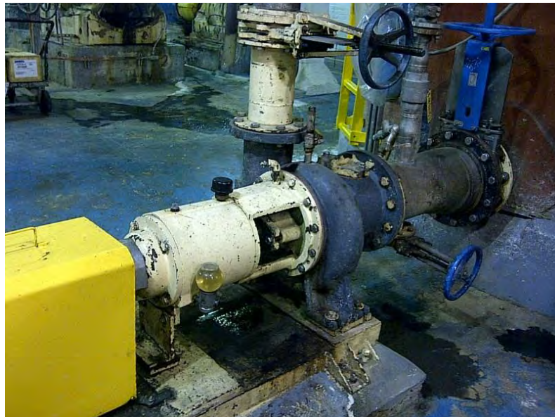
Figura 34. Foto del conjunto Bomba – Motor, sistema de bombeo tanque 4
