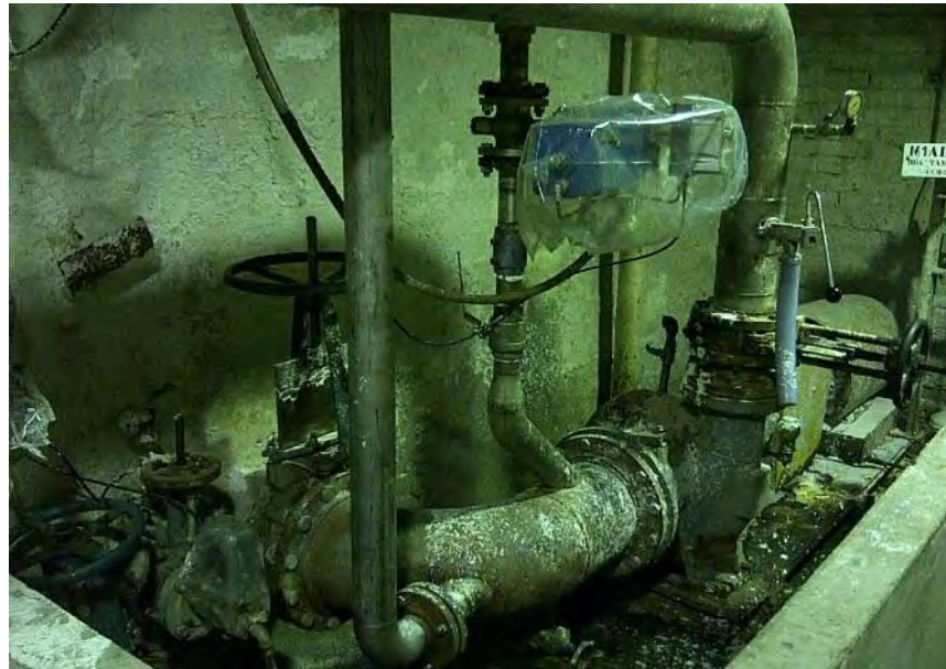
Figura 26. Foto del conjunto Bomba – Motor, sistema de bombeo tanque 12
