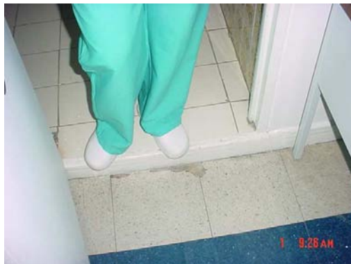
Figura 18. Desnivel de piso sin demarcar y sin banda antideslizante
