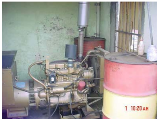
Figura 10. Planta eléctrica sin protección, sin aislamiento, sin señalizar. Combustible sin identificación
