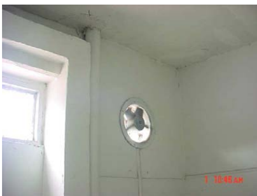
Figura 7. Ausencia de rejillas de protección contra roedores
