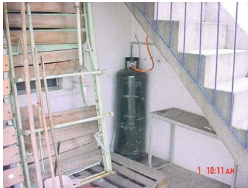
Figura 16. Ubicación inadecuada de pipa con gas, falta de amarre para estabilizarla, materiales que no se utilizan en el área, desorganización
