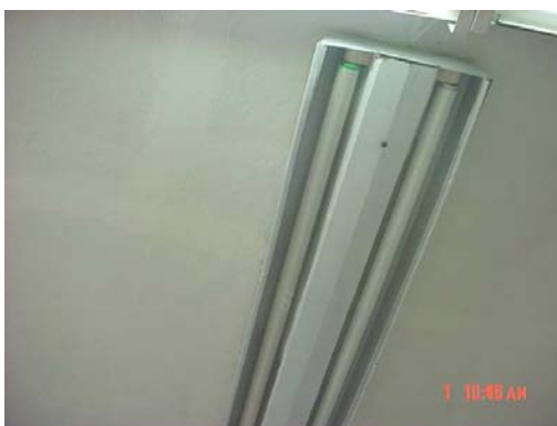
Figura 8. Tubos de luz fundidos
