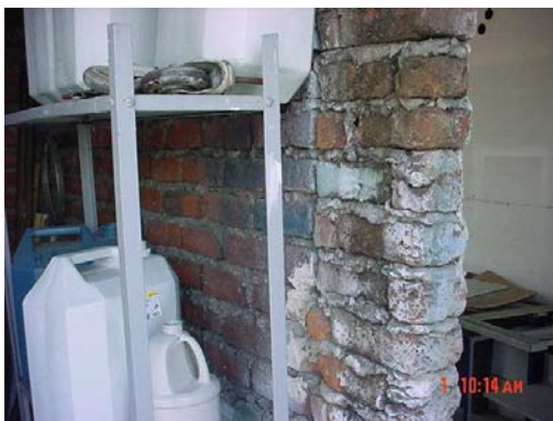
Figura 12. Falta de terminación de paredes, estantes sin anclar
