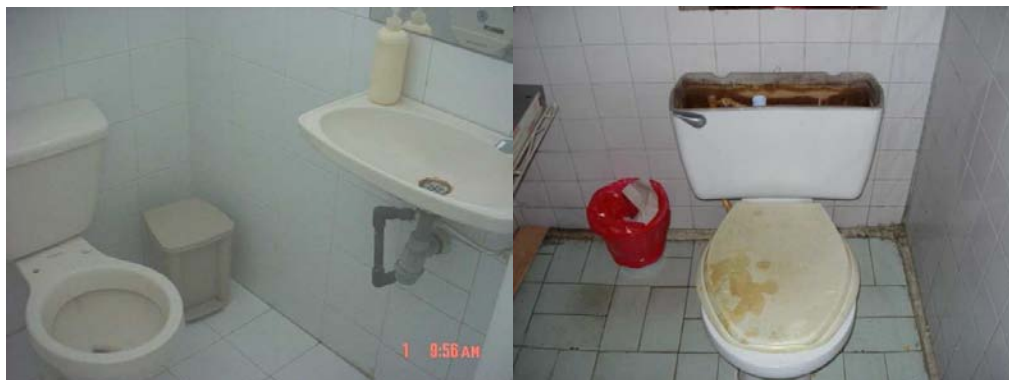
Figura 15. Instalaciones sanitarias en pésimo estado, falta de mantenimiento, falta de bolsa para manejo de desechos contaminados
