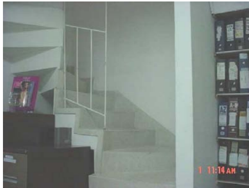
Figura 3. Falta de pasamanos y de banda antideslizante en escalones
