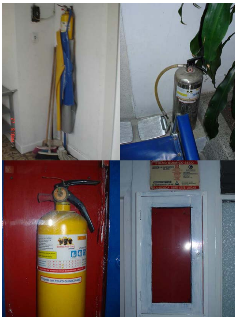
Figura 14. Extintores obstaculizados, sin recargar y sin señalizar
