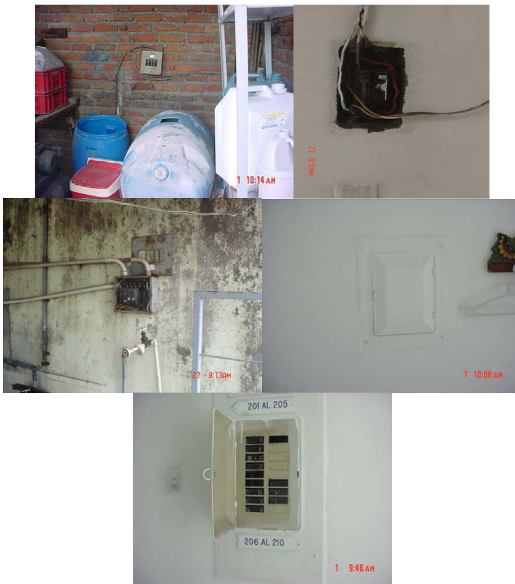
Figura 13. Breakers sin señalar y sin etiquetar. Orden deficiente
