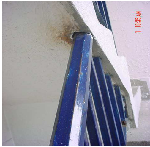
Figura 9. Falta de mantenimiento a baranda
