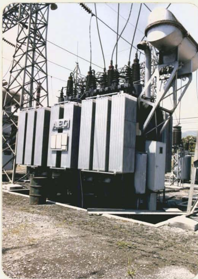
FIGURA 1. Transformador AEG de 58 MVA de 115/37/14 Kv que alimenta zona Industrial de Yumbo.
