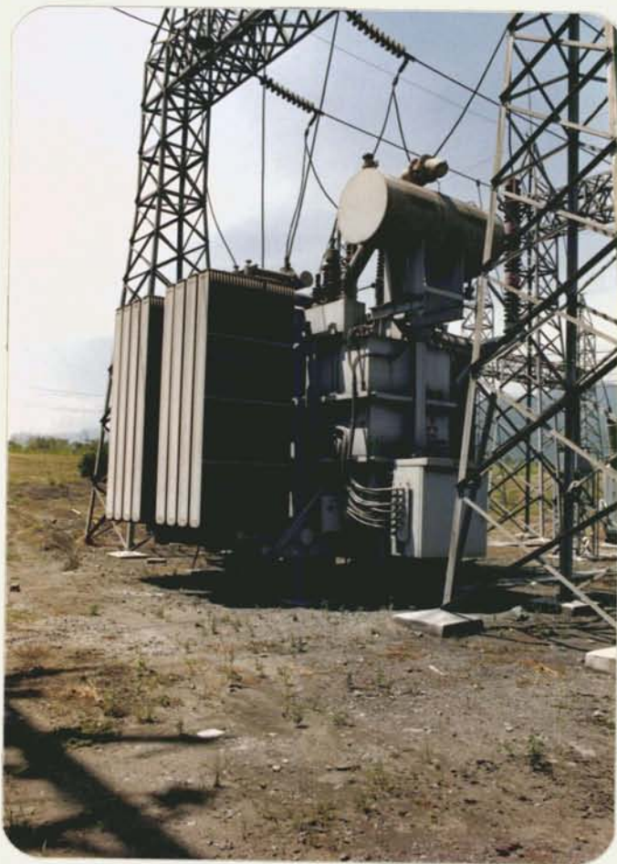
FIGURA 26. Transformador Mitsubishi de 58 MVA 115/37/14 Kv con cambiador de derivaciones bajo carga.
