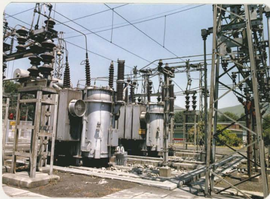
FIGURA 5, Transformadores 1 y 2 de recibo y suministro de la subestación.
