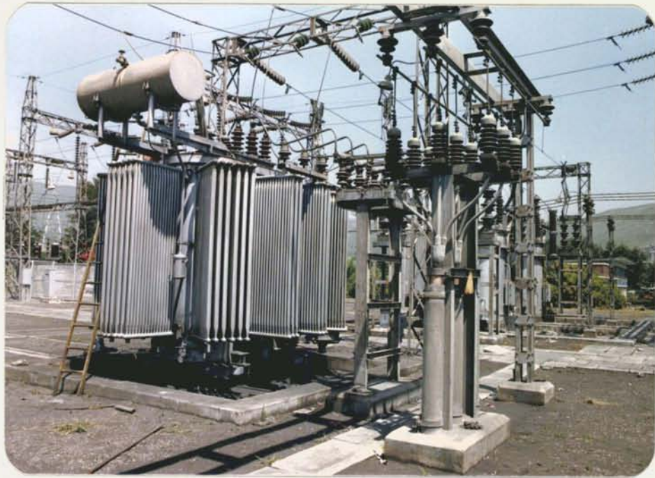
FIGURA 20. Transformador de 15 MVA, 345/13,8 KV instalado al Feeder V del barraje de 13,8 .
