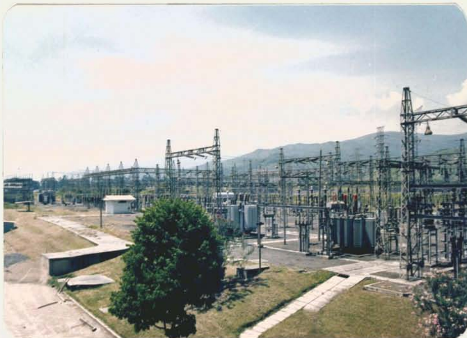
FIGURA 4, Sub-Estación de transformación, distribución e interrupción de la central Termoeléctrica de Yumbo.
