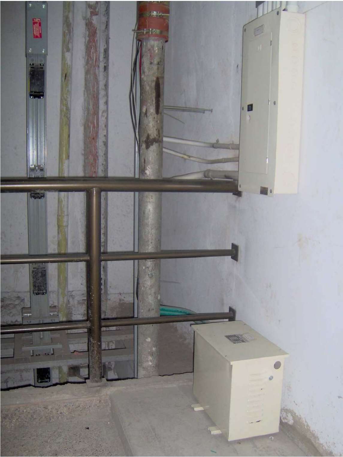
Foto 16. Cuarto eléctrico Edif. Central piso 2 Lado norte, tablero auxiliar y transformador
