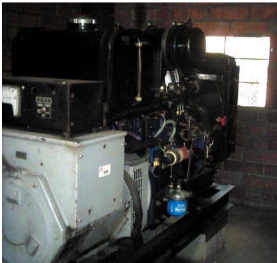
Foto 34. Planta de emergencia sede San Fernando 7.5 Kva. Transferencia manual.
