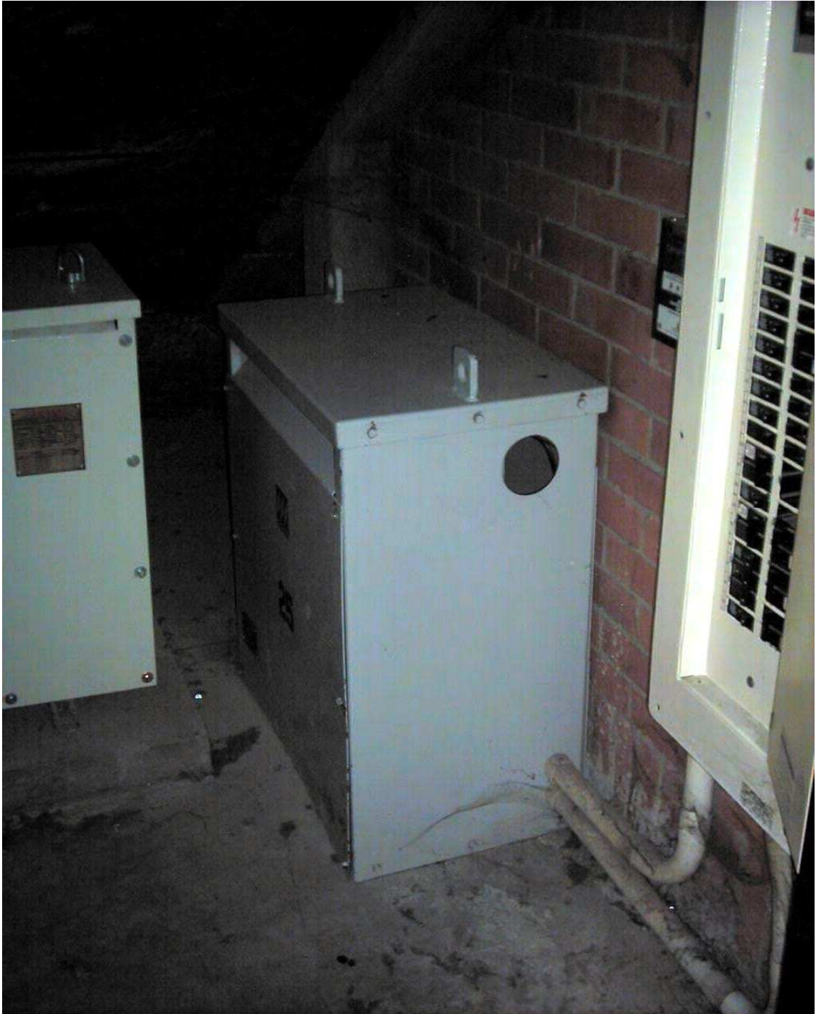
Foto 18. Transformadores y tablero auxiliar, Edif. Central piso 4 lado norte
