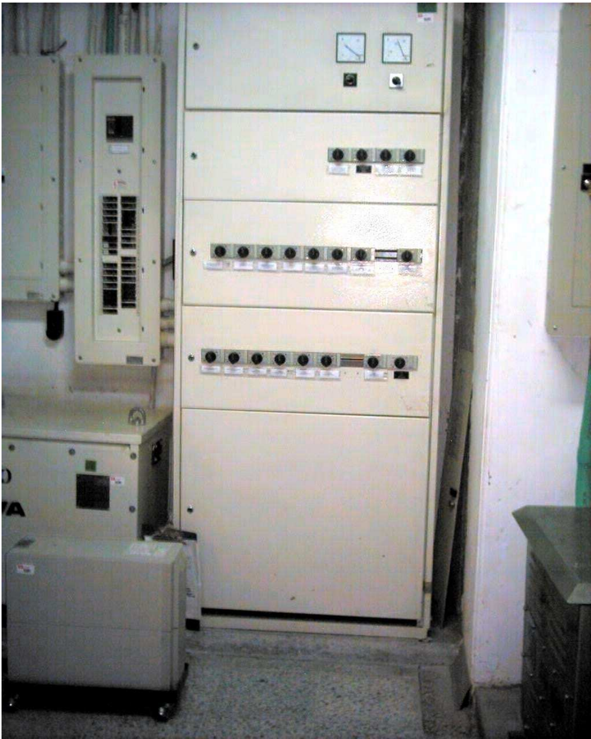
Foto 1. Tablero de distribución, tablero auxiliar, transformadores y ups, sótano lado norte
