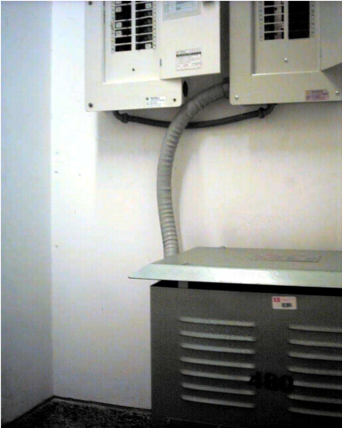
Foto 10. Cuarto eléctrico Ed. Central piso2 lado sur, tableros auxiliares y transformador
