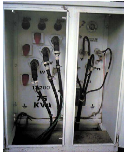
Foto 33. Primario y secundario Subestación Sede San Fernando
