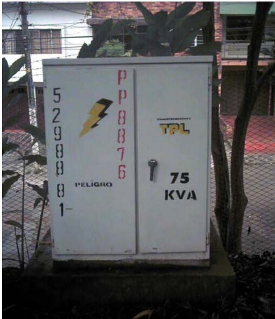
Foto 32. Subestación Sede San Fernando, Transformador 13200/208 V.
