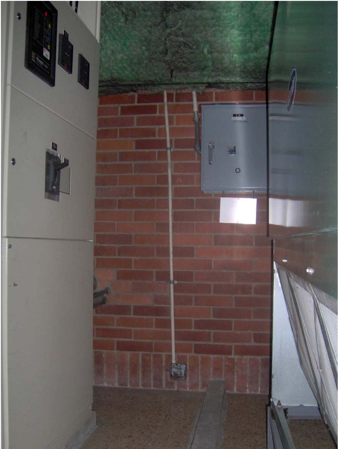
Foto 13. Tablero de Distribución, cuarto manejadora Aires Acondicionados, Ed. Central piso 4 lado sur
