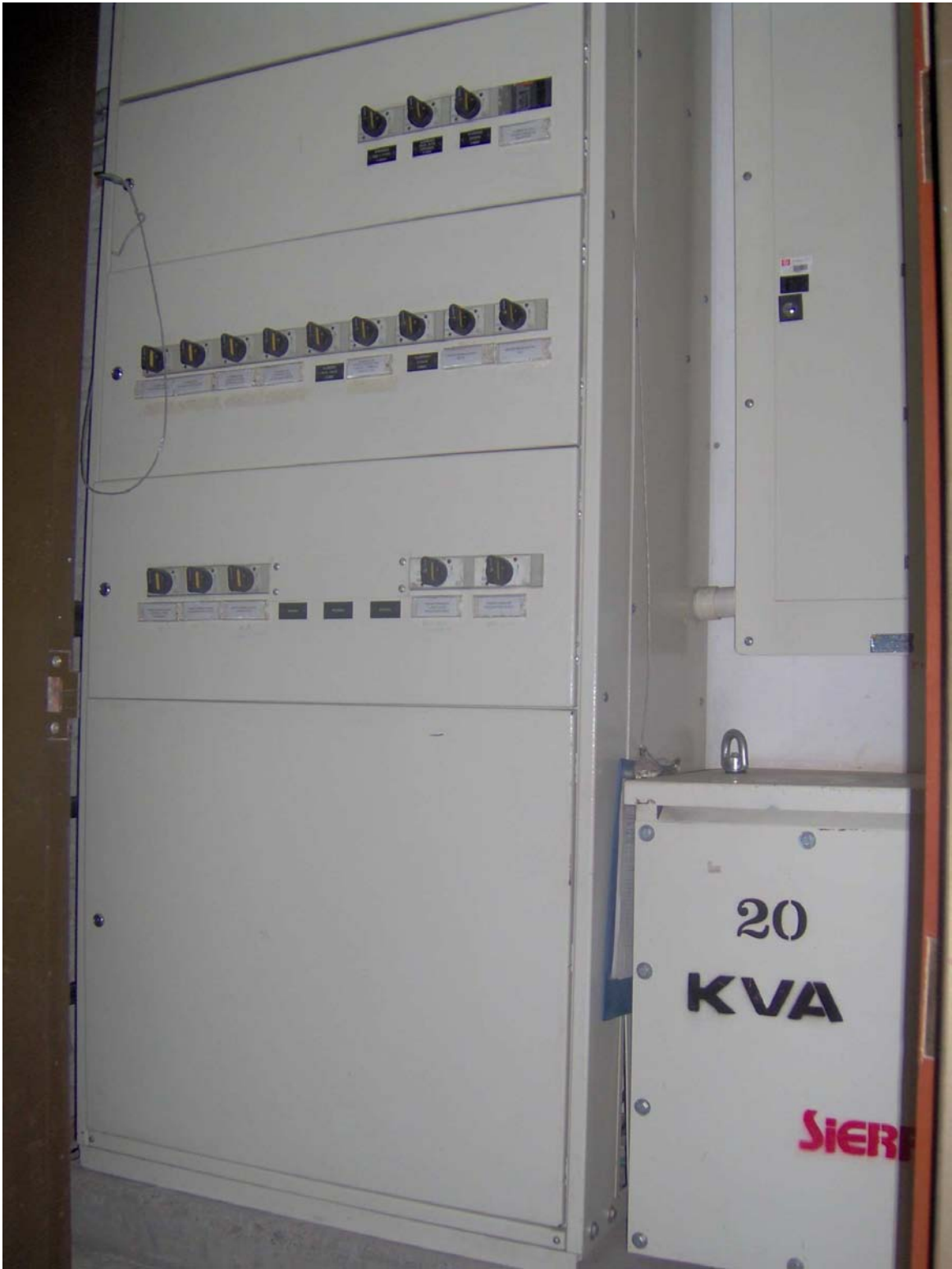
Foto 17. Tablero de Distribución, tablero auxiliar y transformador Ed. Central piso3 lado norte
