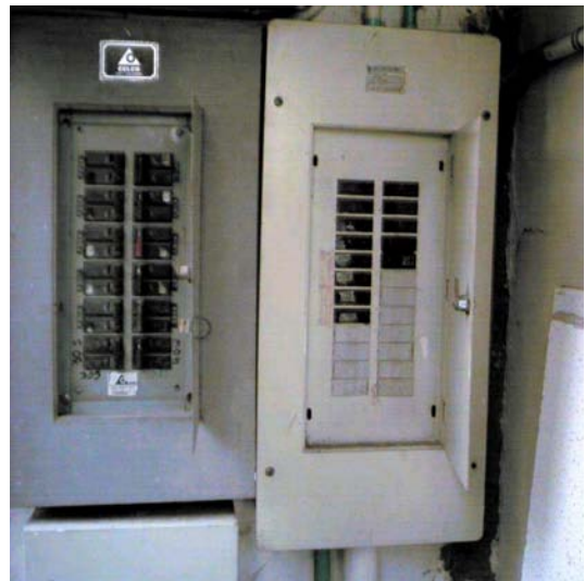
Foto 35. Tableros Auxiliares Sede San Fernando.
