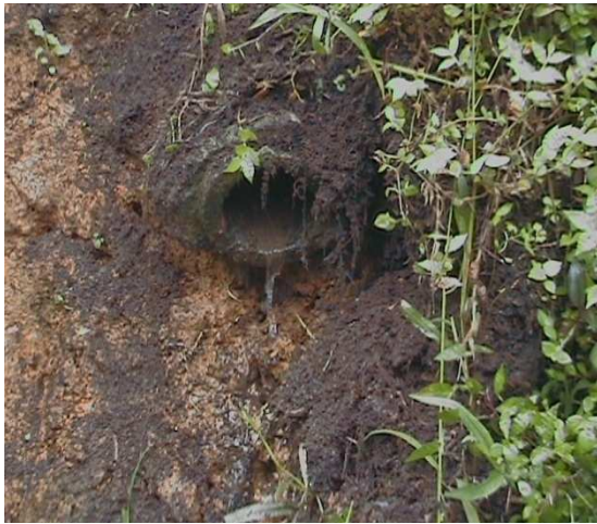
Fotografía N°37 Salida de aguas residuales
