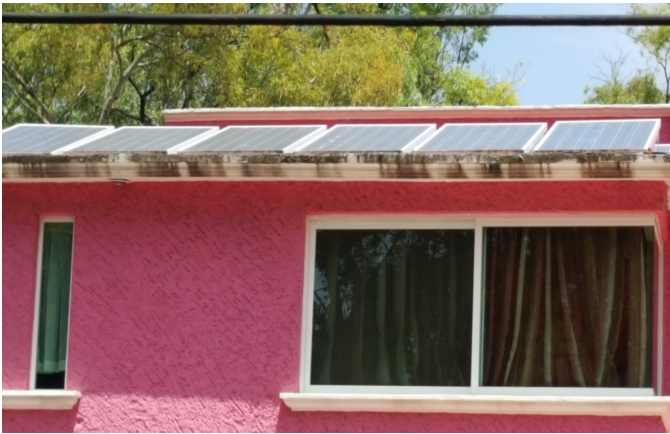
Casa habitación con Sistema de celdas solares. Propiedad de Gabriela Benitez Sanchez
