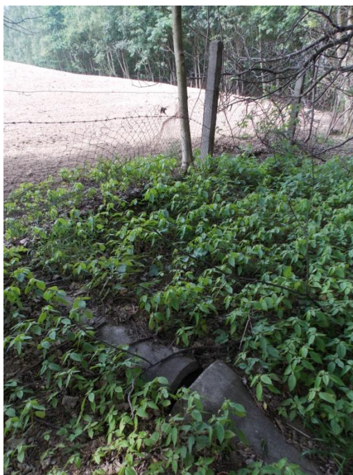
Obr. 12. Poničené odvodnění (meliorace) (DB8).
