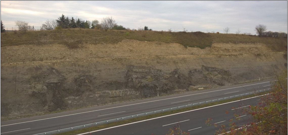
Obr. č. 2: Sesuv v zářezovém úseku Brandýsek.
