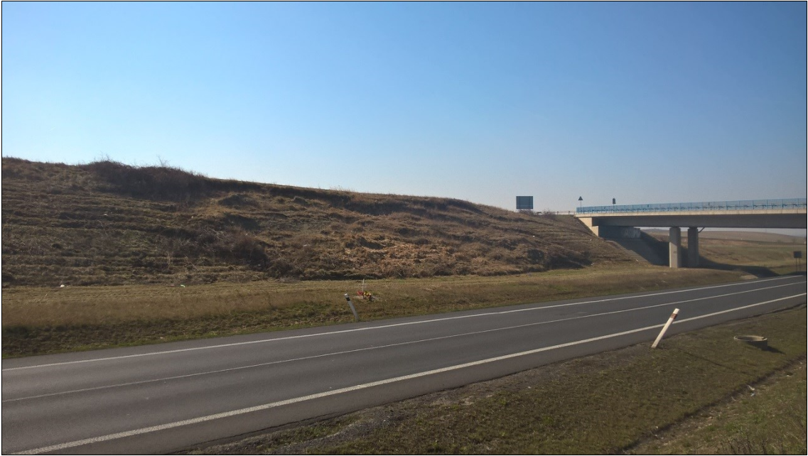
Obr. č. 18: Sesuv S3 v zářezovém úseku Louny-křížení.
