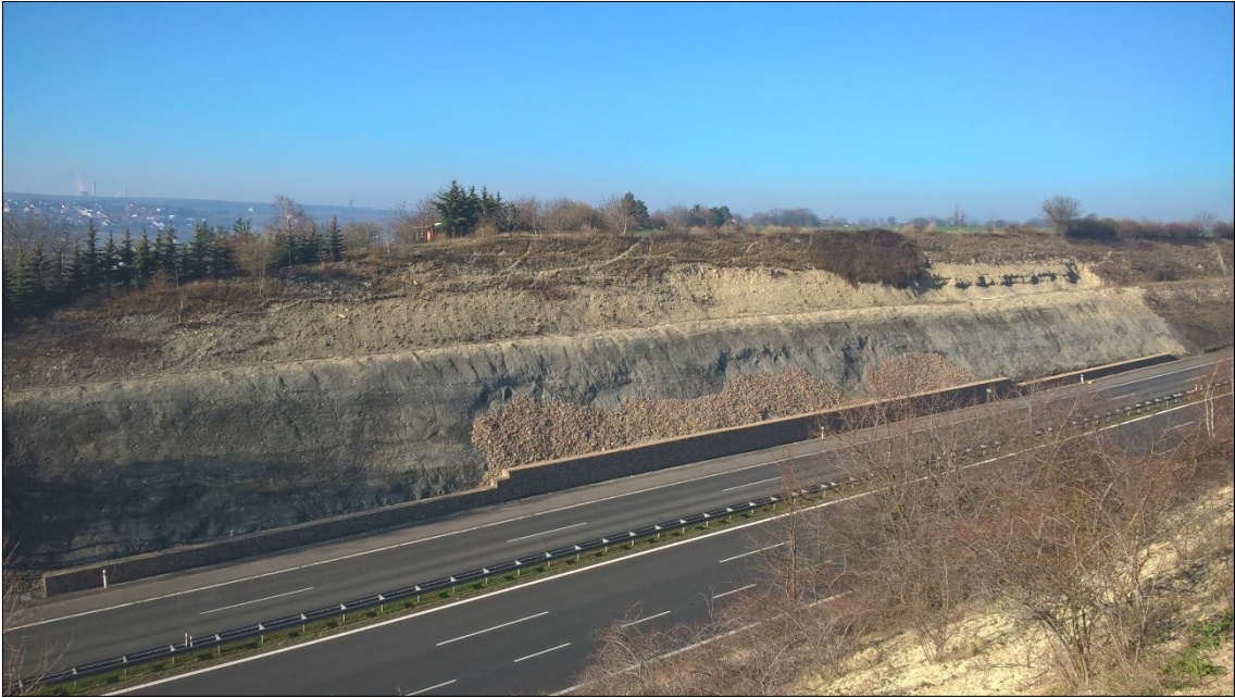
Obr. č. 10: Úvodní část sv. svahu zářezového úseku Brandýsek po dokončení sanačních prací.
