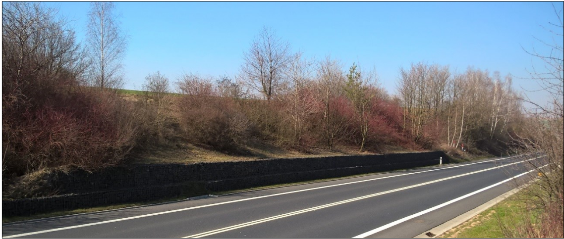
Obr. č. 5: Místo sesuvu v zářezovém úseku Třebíz.
