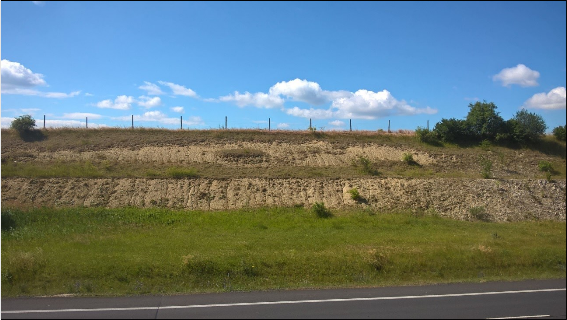
Obr. č. 14: Sesouvání sprašového pokryvu v zářezovém úseku Louny-prům. zóna.
