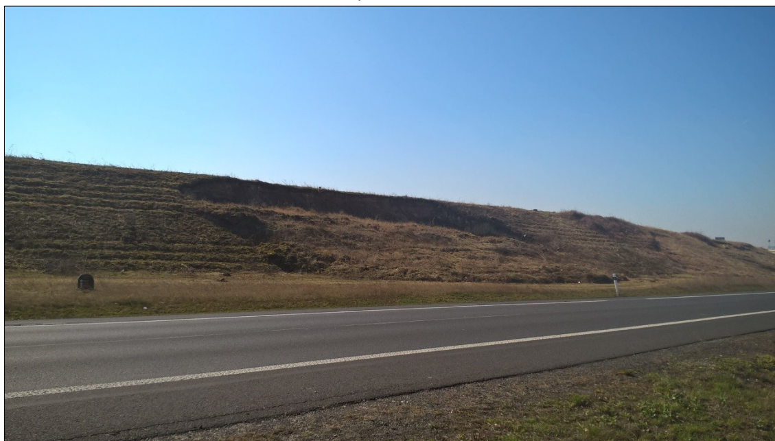
Obr. č. 7: Sesuv S1 v zářezovém úseku Louny-křížení.
