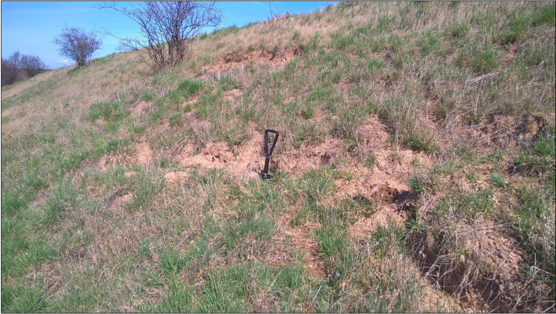
Obr. č. 1: Příklad mělké svahové deformace v zářezovém úseku Stehelčeves.
