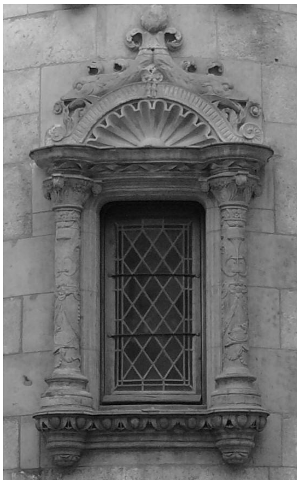
XIII. Bourges, l'Hôtel Lallemant, okno vnitřního dvora.
