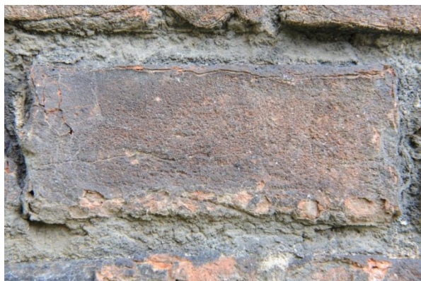
Obr. 20A. Původní zpevněný povrch s povrchovými usazeninami a počínajícím puchýřováním.
