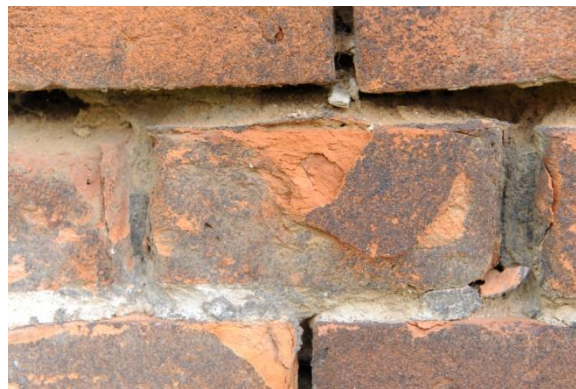
Obr. 20B. Původní i druhotný zpevněný zčernalý povrch, částečně porušený odprisky a obnažené jádro cihly s mnohovrstvým šupinatěním.
