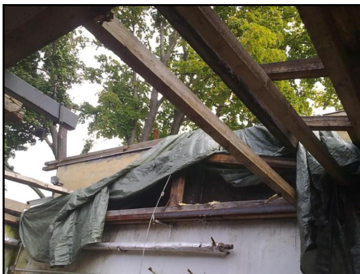
Obr. 49: Část stržené střechy v dostavbě plnírny na severním dvoře.
