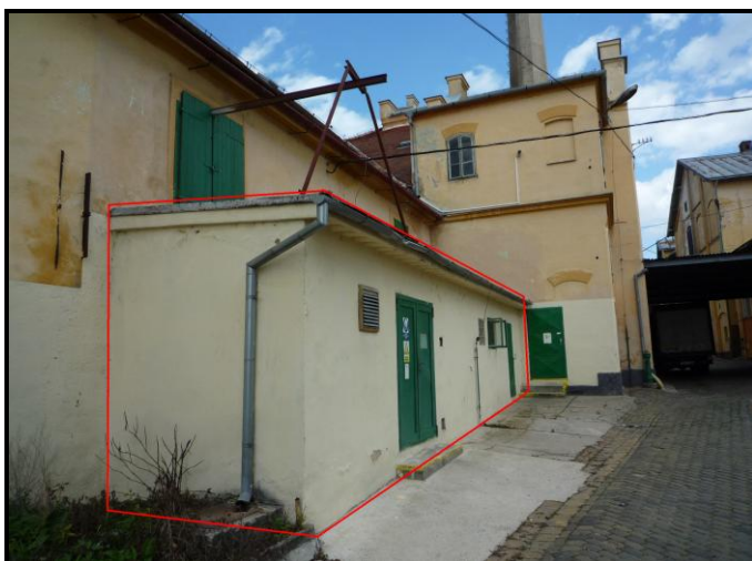
Obr. 31: Moderní trafostanice sladovny, určená k odstranění.
