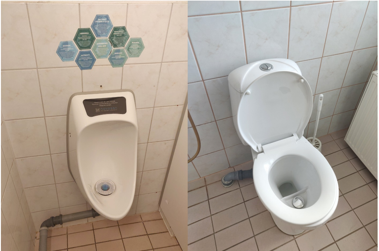
Kuva 7. Erottelevat käymälät, joista virtsa ohjattiin Sanitation 360®-menetelmään. Kuvat: Inka Honkala, TAMK.
