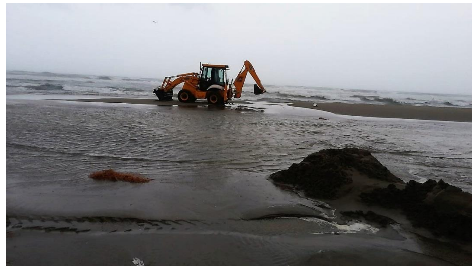
Fig. 4.1.17. Insabbiamento del tratto del canale di foce, presso la spiaggia.
