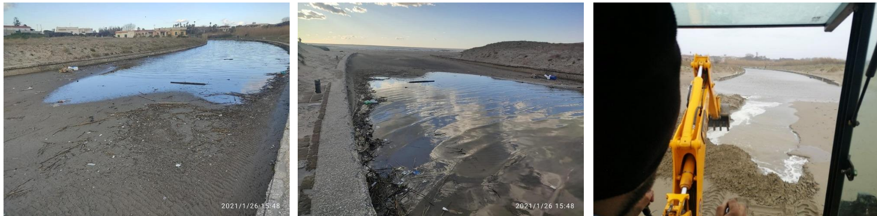
Fig. 5.0.2. Foto a sinistra e centro: Accumulo sabbioso nel tratto finale del canale di foce. Foto a destra: Rimozione della sabbia con ruspa.
