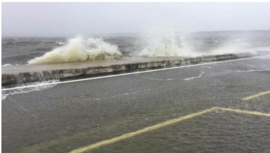
Fig. 4.1.14. Onde battenti sulla strada circumlago.
