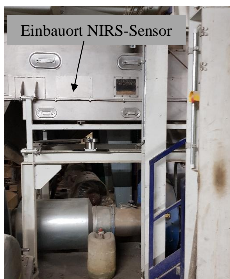
Abbildung 4: Einbauort des NIRS-Sensors in der Prozessstrecke im Bereich des Wirbelstromtrockners
