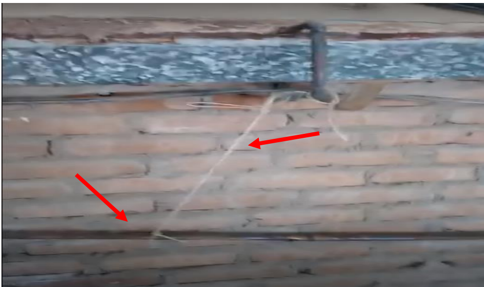
Tubería sostenida de una forma inadecuada a un soporte de otra cañería mediante una cuerda. Inaceptable.
