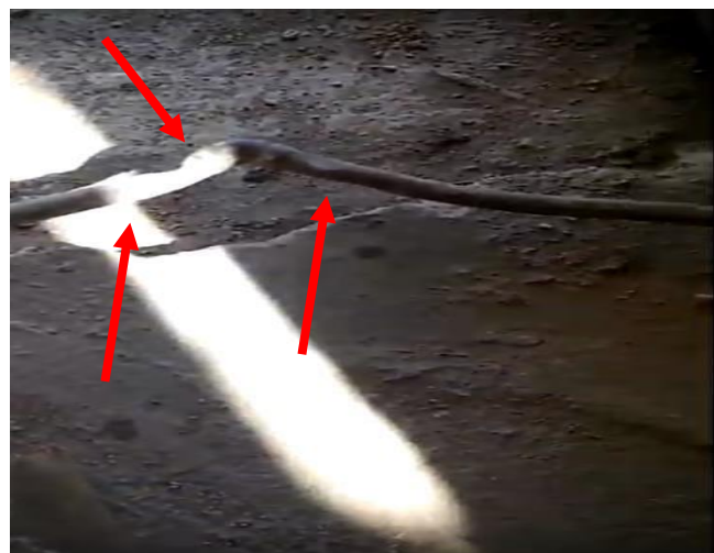
Tubería abollada e inservible para su uso.
