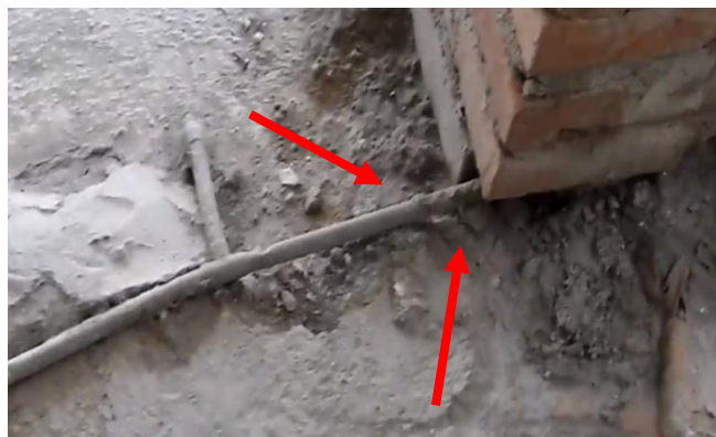
Tubería atraviesa columna en el techo de Quirófano de forma inaceptable.
