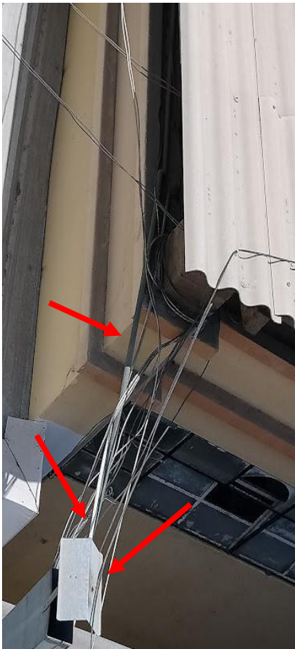
Tubería atraviesa la salida de humo perteneciente al comedor del Hospital Las Mercedes
