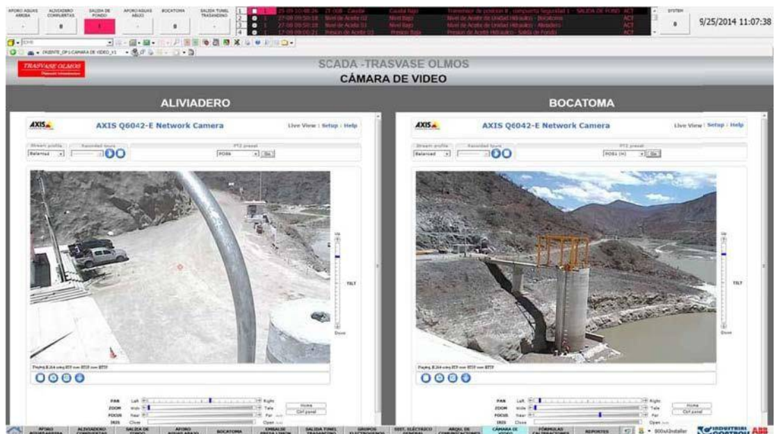
Fig38: Imágenes de cámaras instaladas
