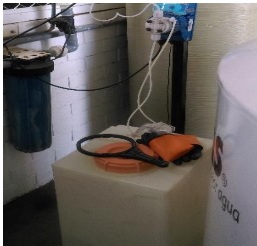
Figura 7. Sistema dosificador de Cloro. Adaptado de Planta potabilizadora de Agrícola Cerro Prieto
