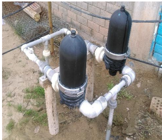
Figura 1. Filtro de Anillas. Adaptado de Planta Potabilizadora de Agrícola Cerro Prieto
