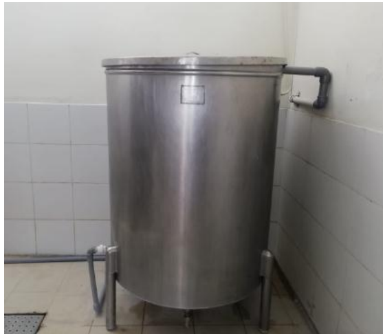
Figura 2. Tanque de sedimentación. Adaptado de Planta Potabilizadora de Agrícola Cerro Prieto
