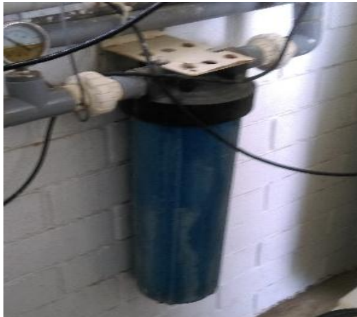
Figura 3. Filtro de Anillas. Adaptado de Planta potabilizadora de Agrícola Cerro Prieto
