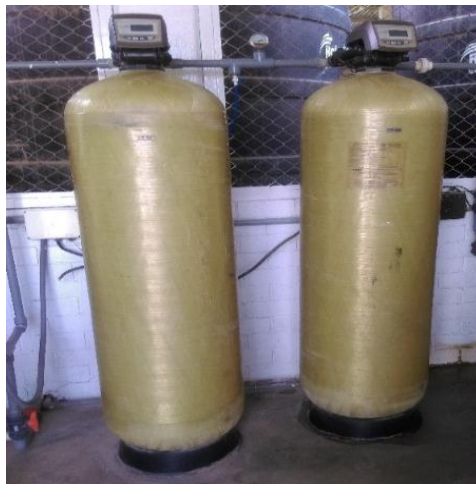
Figura 5. Filtros de Carbón Activado. Adaptado de Planta potabilizadora de Agrícola Cerro Prieto
