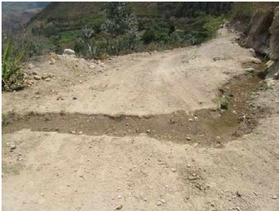
Foto 4.1.14: En las imágenes se muestra necesidad de construir obras de drenaje de las aguas que cruzan por la sección de la vía
