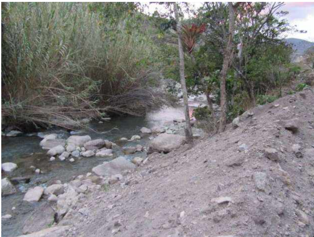
Foto 4.1.17: En el sector de la vía por donde pasa el agua de la quebrada Tocras es necesario la construcción de un Puente, pues en épocas de lluvias y crecidas se es imposible el tránsito.
