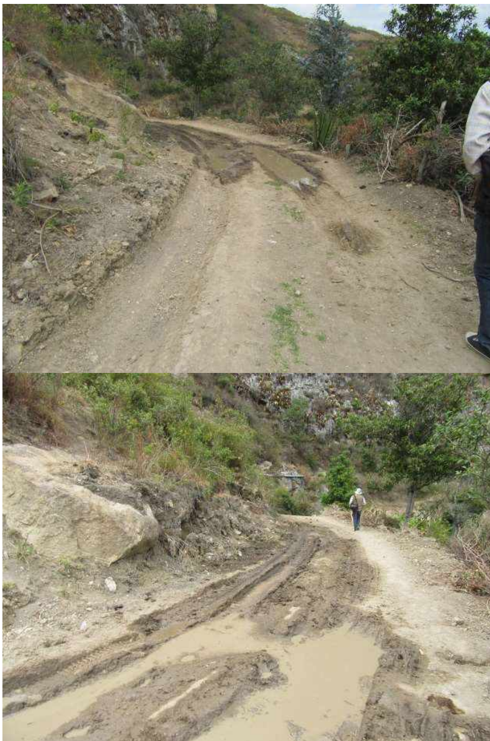
Foto 4.1.13: En las fotos se muestra claramente como queda la vía enlodada ante una lluvia, produciendo que los vehículos tengan que reducir su velocidad para poder pasarla, y como consecuencia el tiempo de viaje se incrementa.
