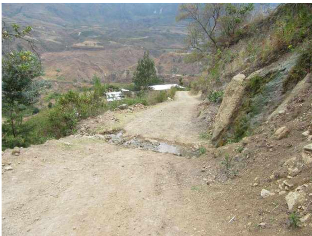
Foto 4.1.15: En la imagen Se muestra la necesidad de construcción y mejoramiento de cunetas y alcantarillas que drenen el agua superficial que se genera en la zona
