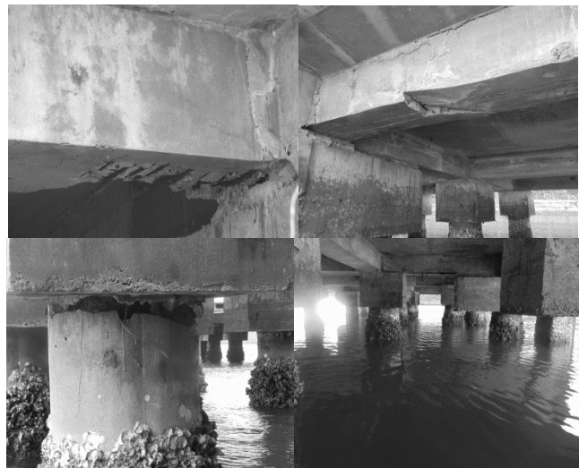
Gambar 1. Kondisi Struktur Dermaga yang mengalami kerusakan akibat korosi dan spalling beton
