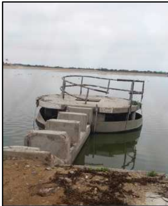
Figura 15. Estructura de entrada del afluente a lagunas secundarias
