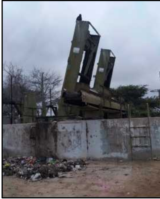
Figura 14. Cámara de rejas
