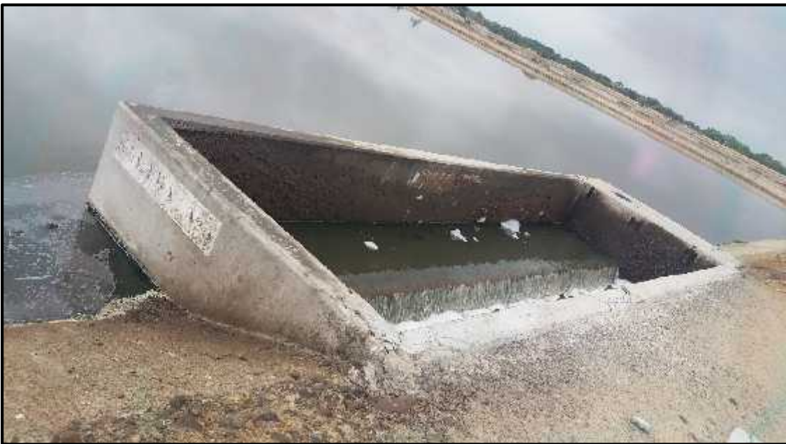
Figura 13. Estructura de salida del efluente de lagunas primarias
