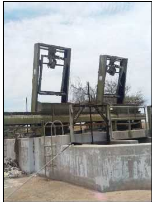
Figura 18. Cámara de rejas
