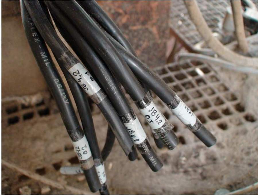
FIGURA 108: CABLE CORTADO ANTES DE LA AUTOMATIZACIÓN. Fuente: Propia
