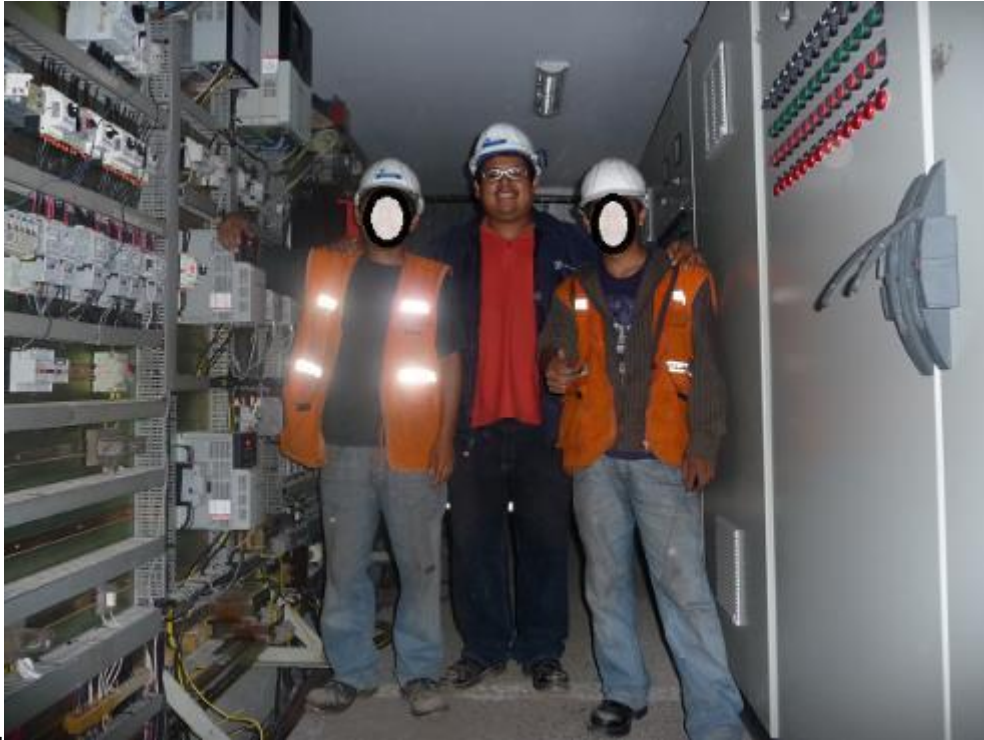
FIGURA 116: DENTRO DEL CENTRO DE CONTROL DE MOTORES CON LOS TABLEROS DE CONTROL (NUEVOS) Y FUERZA (DE ESPAÑA). Fuente: Propia
