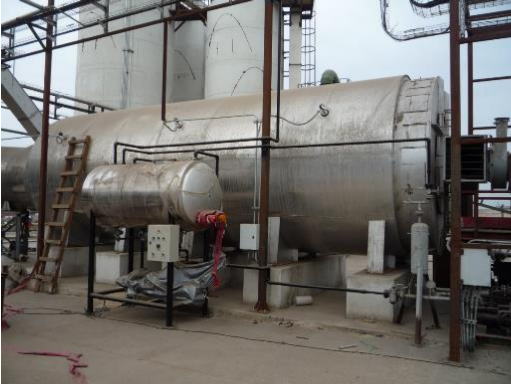
FIGURA 114: CÁMARA DEL QUEMADOR. Fuente: Propia
