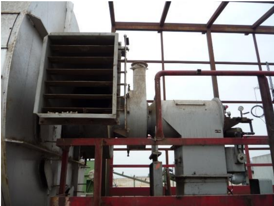
FIGURA 113: TOMA DE AIRE Y SISTEMA DE ENCENDIDO DEL QUEMADOR. Fuente: Propia
