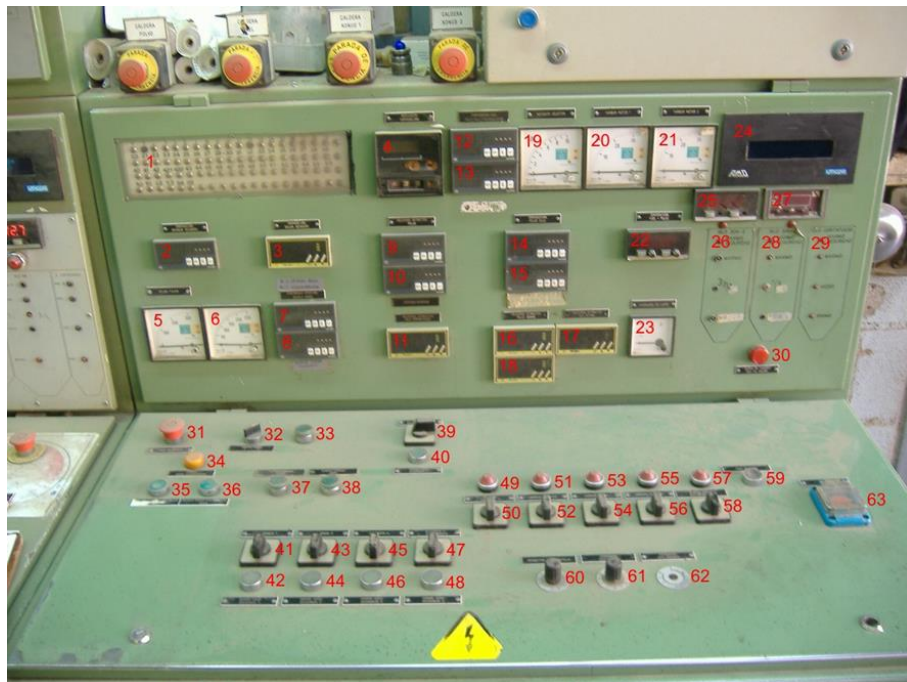
FIGURA 106: PUPITRE ANTES DE LA AUTOMATIZACIÓN Fuente: Propia
