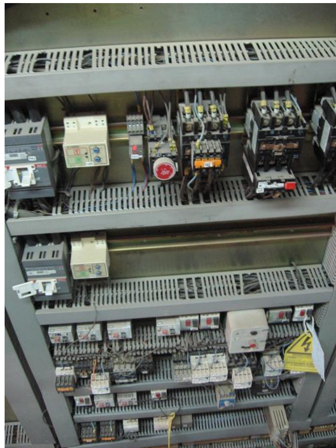
FIGURA 107: TABLERO DE FUERZA ANTES DE LA AUTOMATIZACIÓN. Fuente: Propia
