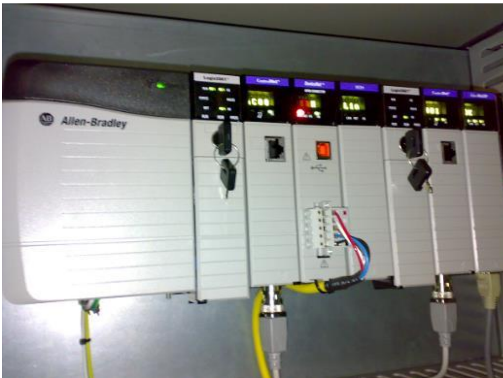
FIGURA 117: CONTROLADOR DE AUTOMATIZACIÓN PROGRAMABLE EN FUNCIONAMIENTO. Fuente: Propia
