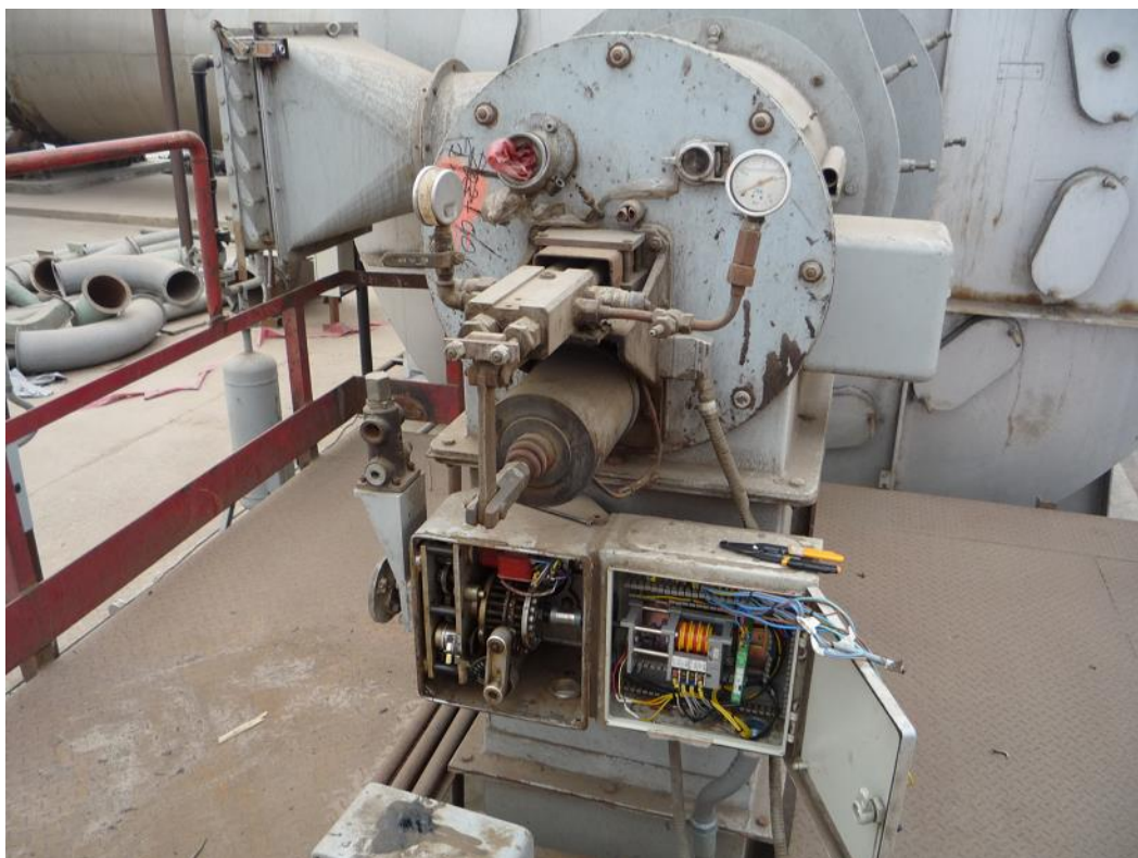
FIGURA 111: SISTEMA DE IGNICIÓN DEL QUEMADOR ANTES DE LA AUTOMATIZACIÓN. Fuente: Propia
