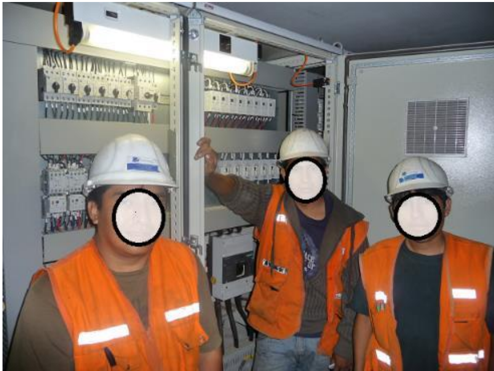
FIGURA 115: TABLERO DE CONTROL EN COMISIONAMIENTO. Fuente: Propia
