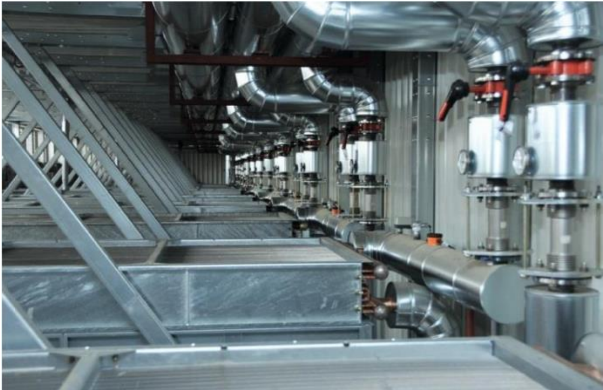
FIGURA 5: TUBERÍAS INTERNAS DEL SECADOR DE BANDA.
