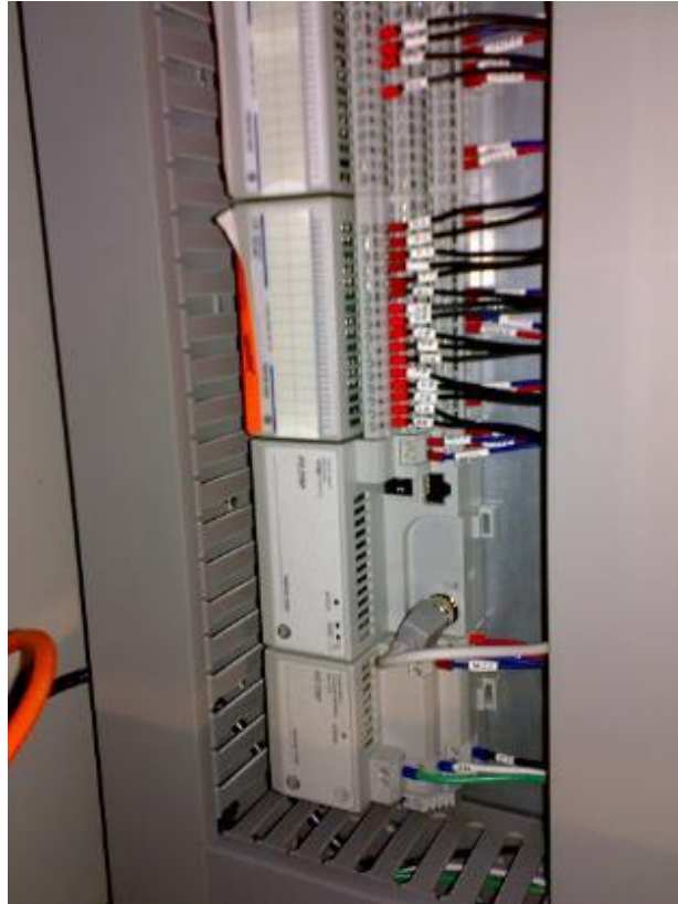
FIGURA 118: FLEX IO (FUENTE, MÓDULO DE RED CONTROLNET Y MÓDULO DE ENTRADAS DISCRETAS).
