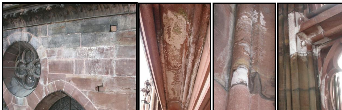
Figure I-7 : Différentes morphologies d'altérations liées à la présence des sels sur les grès de la cathédrale.
