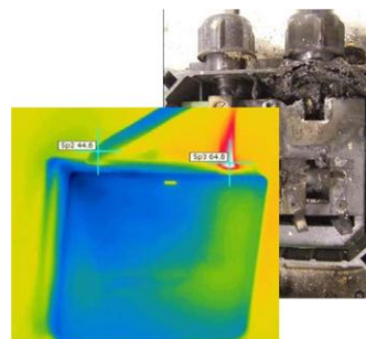
(b) corrosion dans la boîte de jonction
