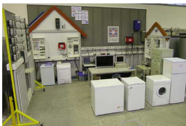
Figure II-5: Site de test DoMoTec d'un logement [BRAU, 09]
