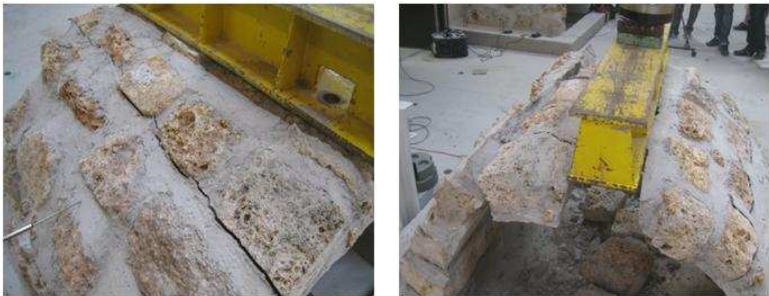
Fig. IV- 13: fissuration dans les joints du mortier au niveau des reins à l'extrados et en clé
