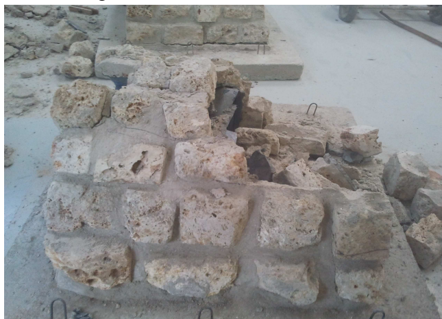
Fig. VI- 22: effondrement d'une voûte renforcée par tissus de carbone
