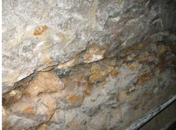
Fig. I- 4 : déjoints de maçonnerie
