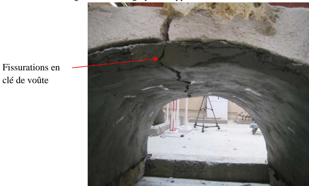
Fig. V- 14 : fissuration en clé de voûte enduite à l'intrados
