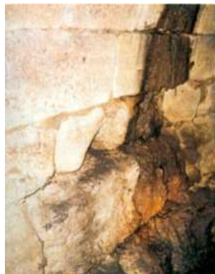
Fig. I- 3: défauts des pierres en présence d'infiltrations d'eau
