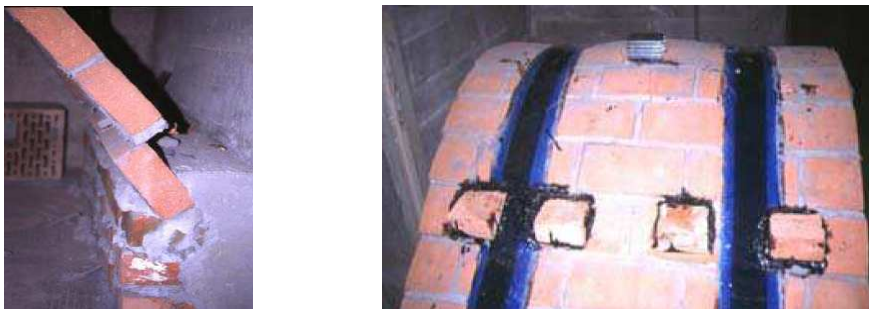
Fig. II- 21 : le glissement le long d'un joint de mortier
