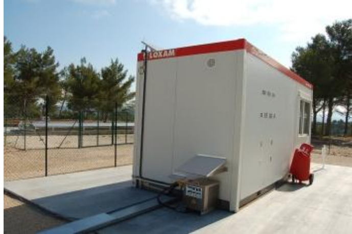
Fig 5-82: Photo du conteneur du nœud électrique et de la supervision
