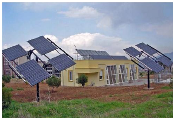
Fig 1-56 : Installations du Clean Energy Center en Turquie
