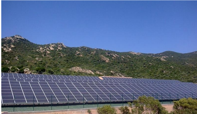
Fig 1-58: Champ photovoltaïque du projet MYRTE
