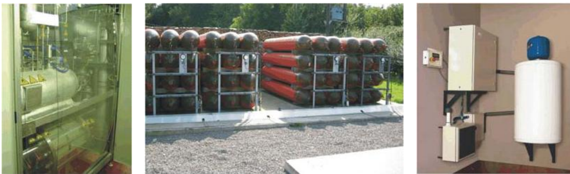
Fig 1-51 : Photos du système de stockage d'hydrogène du projet HARI
