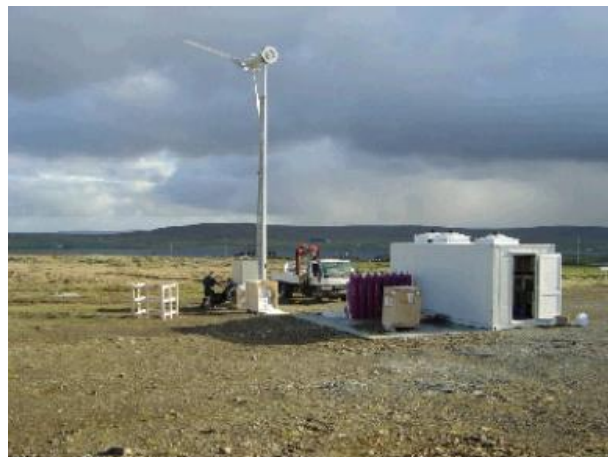
Fig 1-55 : Photo des installations du projet PURE
