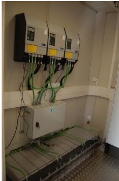
Fig 5-87: Onduleurs Studer et batteries Enersys
