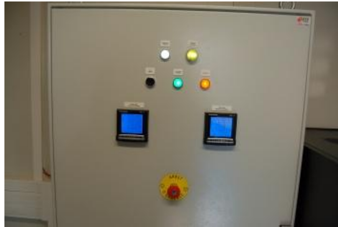
Fig 5-86: Armoire de mesure et de gestion des énergies
