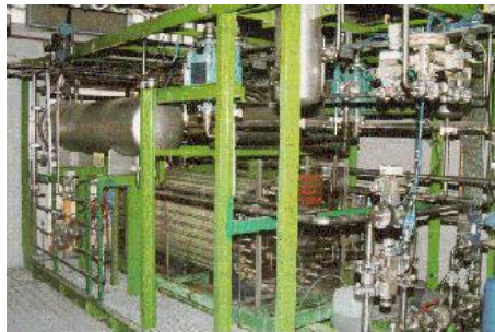
Fig 1-39 : Electrolyseur de 350kW près de Riyad
