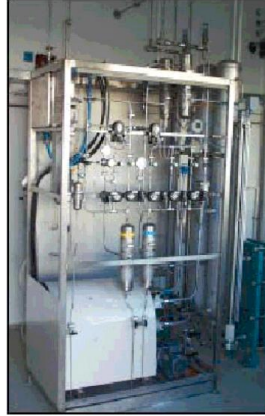
Fig 1-46 : Electrolyseur de Stralsund
