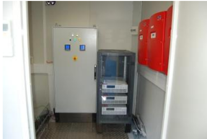
Fig 5-88: Emulateur photovoltaïque à côté des onduleurs SMA
