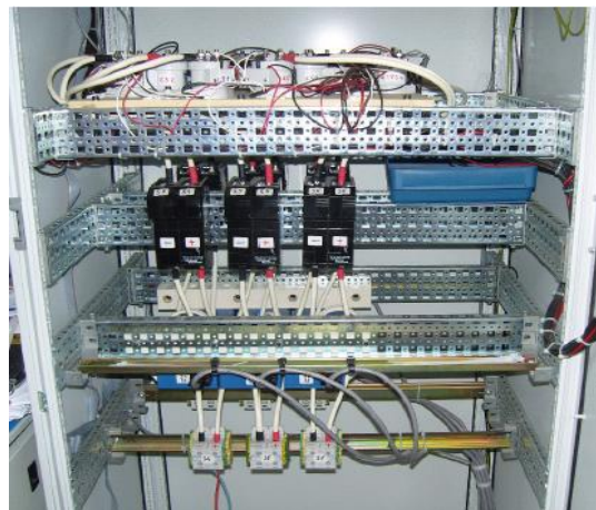
Fig 5-6: Vue intérieure de l'armoire d'interconnexion
