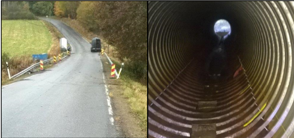
Kuva 2.6. Nitlaxintie 500, Raasepori. Vasemmalla on esitettyä yleiskuva koekohteen tiestä, joka oli ohutpäällysteinen ja vähäliikenteinen. Oikealla on esitettyä kuva rummun sisältä. Rummun halkaisija oli 1200 mm ja peitesyvyys noin 3 metriä. Rumpu oli ruostunut alaosaan.
