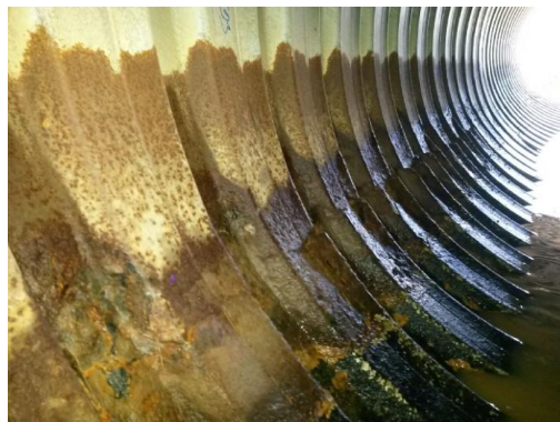
Läpiruostuneet kohdat ovat veden vaihtelualan puolella välissä.
