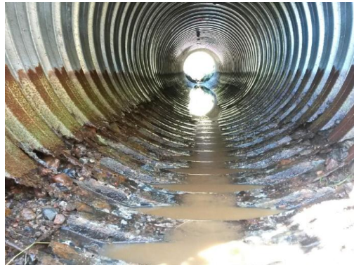
Kuva alajuoksulta kun rumpu on pesty. Putken alaosa on ruostunut ja peltiä puuttuu.
