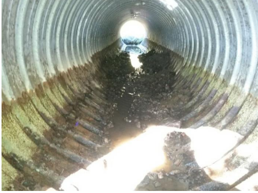
Oja padotettiin ma 17.8. Rumpuun oli kertynyt jonkin verran kiviainesta.
