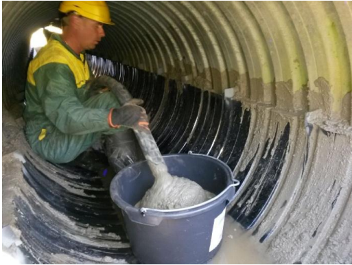
S4 vaikutti aluksi liian jäykältä ahtaaseen väliin, joten työmaalla massaan lisättiin notkistinta.
