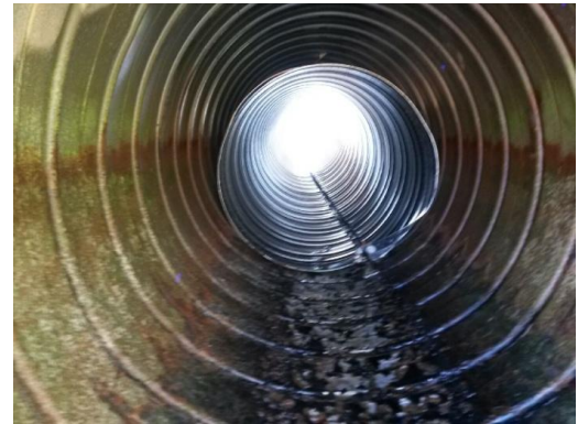
Ennen sujutusta putkessa oli nähtävissä ruostetta mutta ei vielä läpiruostuneita kohtia.
