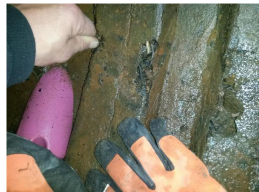
Korkeudella vesijuoksu + 5...+ 15cm oli huonompia ja läpivuotuneita kohtia.
