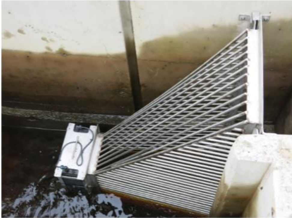
Kuva 6. Peruksen Vaki-kalalaskurin havainnointiyksikkö asennettuna kalatien pystyrako-osuudelle.
