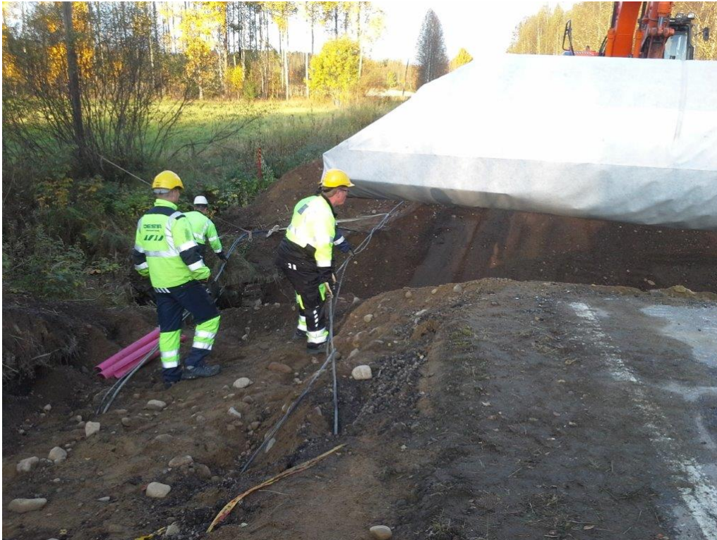
Kuva 5. Telekaapeleiden aiheuttama haitta rummunvaihtotyölle. (Kuva: Raija Kreutzer)
