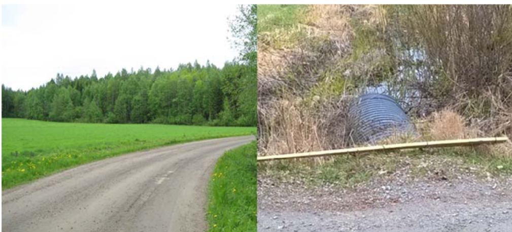
Kuva 2.9 Muovirumpu, halkaisija 800 mm, peitesyvyys 0,2 m. Vasemmalla yleiskuva tiestä, jossa rumpu sijaitsee. Oikealla kuormitettava rumpu.
