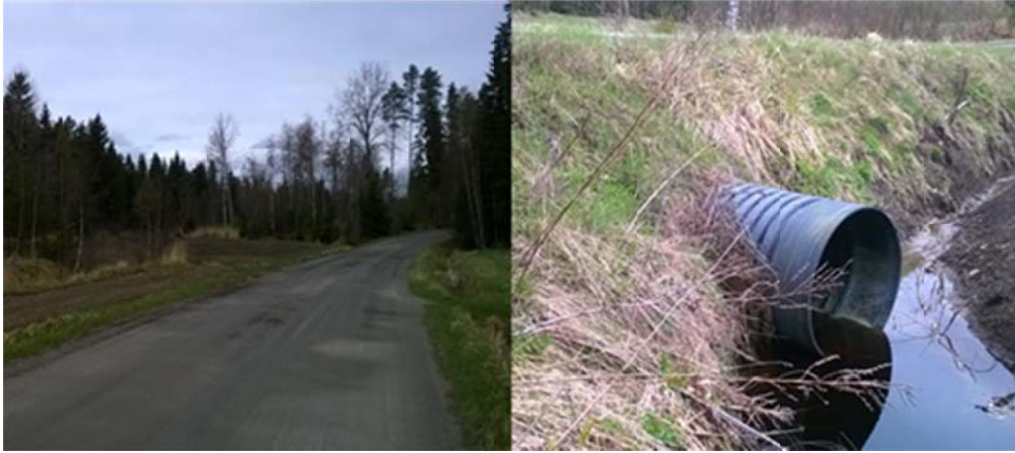
Kuva 2.8 Muovirumpu, halkaisija 800 mm, peitesyvyys 800 mm. Vasemmalla yleiskuva tiestä, jossa rumpu sijaitsee. Oikealla kuormitettava rumpu.
