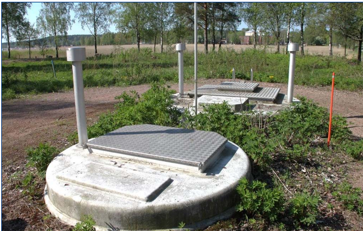
Bild 7.3.2-1. Pumpstationen för avloppsvatten vid korsningen Mannerheimgatan och Skärgårdsvägen (Foto: FCG Suunnittelu ja tekniikka Oy, av den 23.5.2014).
