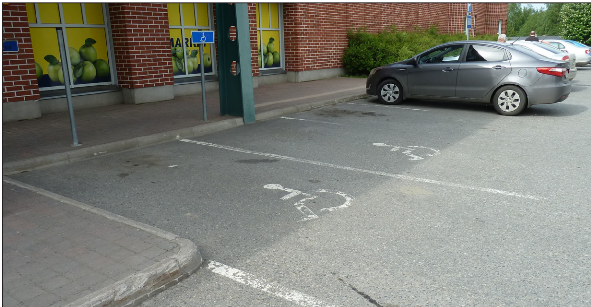
Kuva 44. Kulkuyhteydet LE-paikoilta kaupan sisäänkäynnille ovat huonot korkeiden reunakivien vuoksi.
