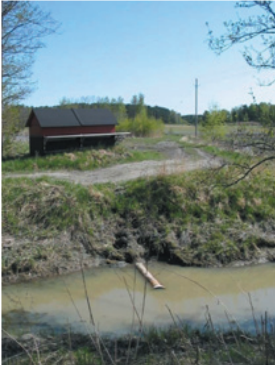
Kuva 9. Kaksikerrassa sijaitseva ojavedenpuhdistamo. Puhdistamolaitteiden suojaksi on rakennettu puinen mökki. Etualalla on ojaveden ottoputki. Kuva: Turun kaupunki/Ympäristönsuojelutoimisto
