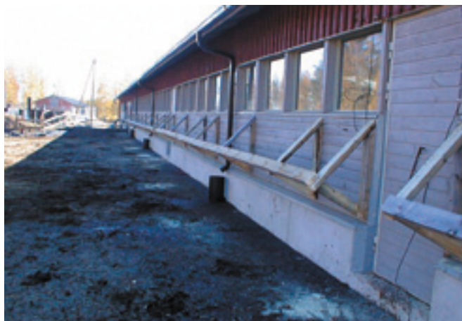
Kuva 9. Sadevedet johdetaan sadevesiputkistoon, josta ne voidaan päästää suoraan ojaan. Rakennuksen seinän suojaamiseksi on rakennettu "hankausesteet". Kuva: Maarit Hellstedt
