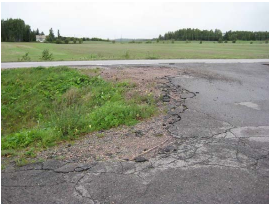
Kuva 19 Alueella 174/4/1495 liittymähaarojen kunto on huono
