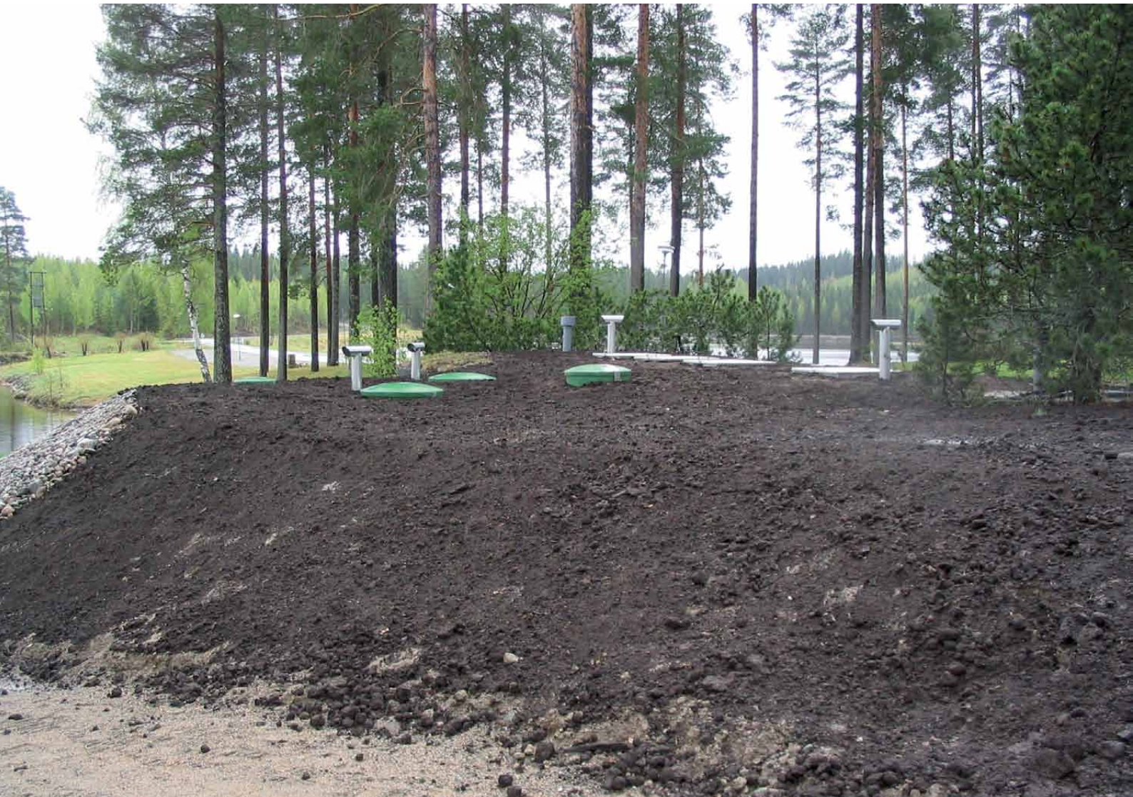
Kuva 12. Ruuponsaaren lomahotellin jätevedenpuhdistamo Viitasaarella. Kuva: Kai Voutilainen.
