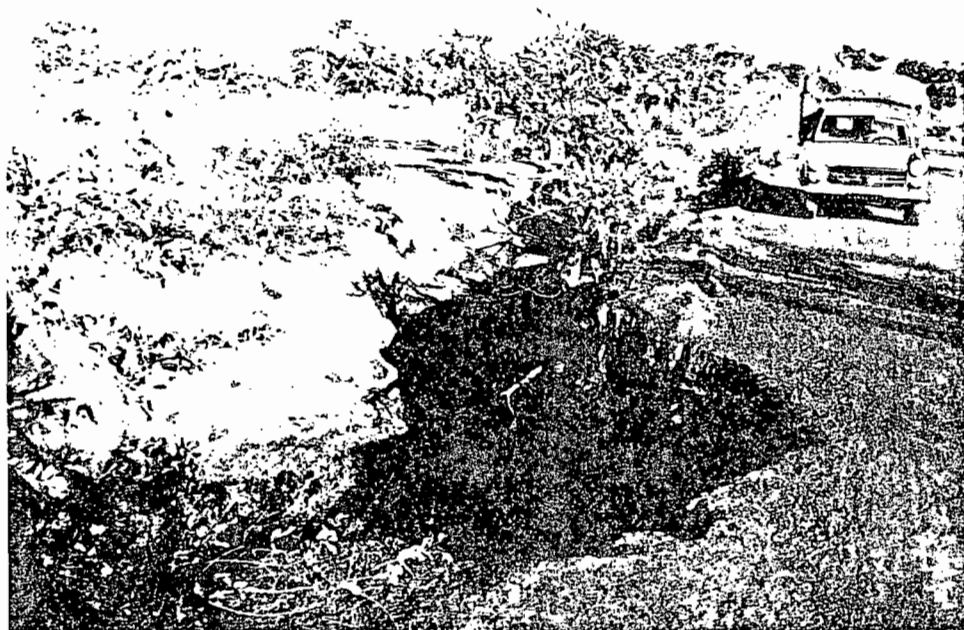
Figure 17 : Les déversoirs des banquettes anti-érosives produisent de nombreuses dégradations aux axes routiers...
