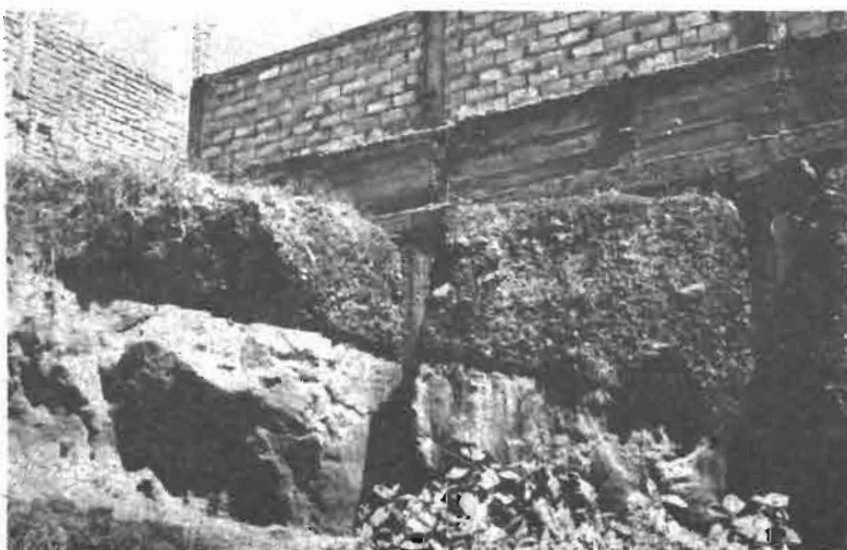
Foto 10: Latacunga: construcciones sobre depósitos laháricos (orilla izquierda del Cutuchi).
