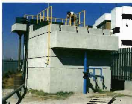
Réacteur UASB pilote de 50m 3 UAM1 pour le traitement des eaux usées urbaines Mexico - photo JP. Guyot
