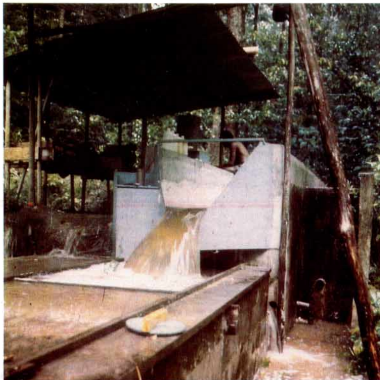
Déversoir H Flume (bassin F)
