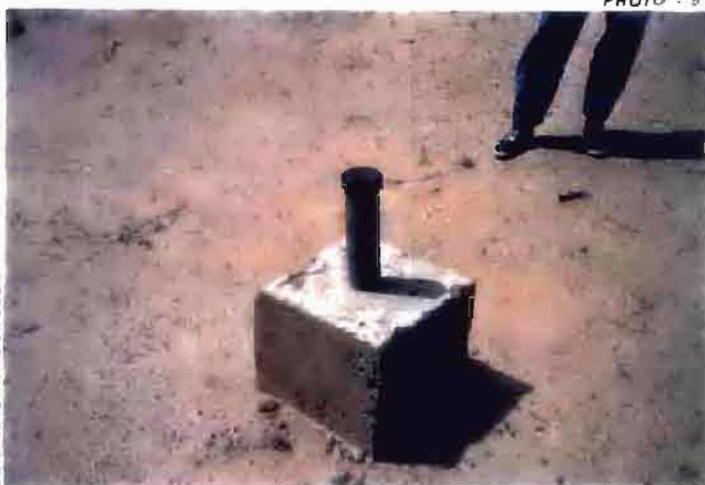
Partie aérienne d'un piézomètre - Bidi - (Burkina-Faso)
