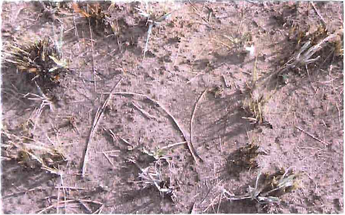
Photo 13. Pellicule salée de surface (route Kourou Sinnamary, photo M. Lointier).
