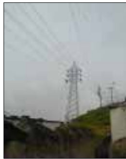
Foto A: Torres del sistema eléctrico en sitios de pendientes Fuente: IRD 2003
